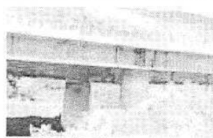
IL PILONE CHE HA CEDUTO SULLA A/19
